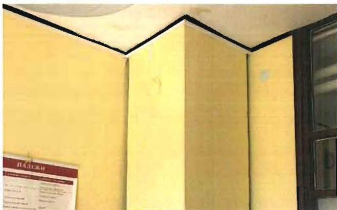
Slika 1. Karakteristično oštećenje: Dimnjaci nisu vezani za konstrukciju i skloni su padu.
